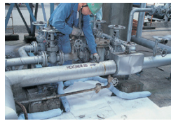
▲作業中の漏油に
