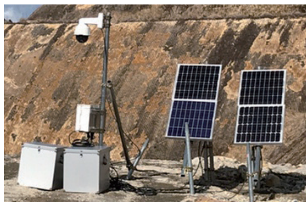
ソーラー電源BOX 映助ch
