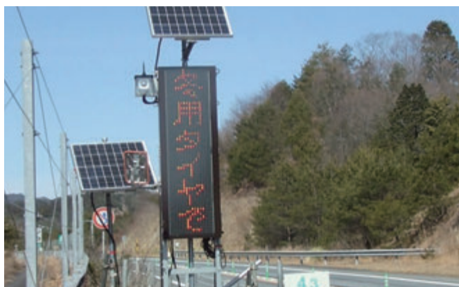
浜田自動車道 ソーラー専用架台
